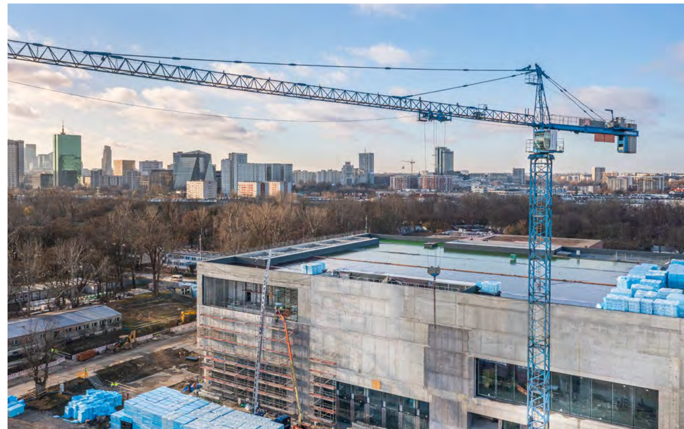
↑ Budowa siedziby Muzeum Historii Polski – widok z drona Construction of the seat of the Polish History Museum, a view from a drone
